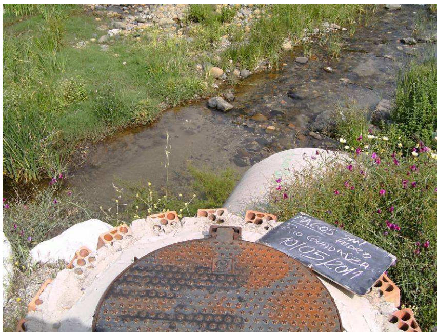
Figura 9. Arqueta y tubo de vertido junto al cauce del río Guadaiza (10/05/2011)
