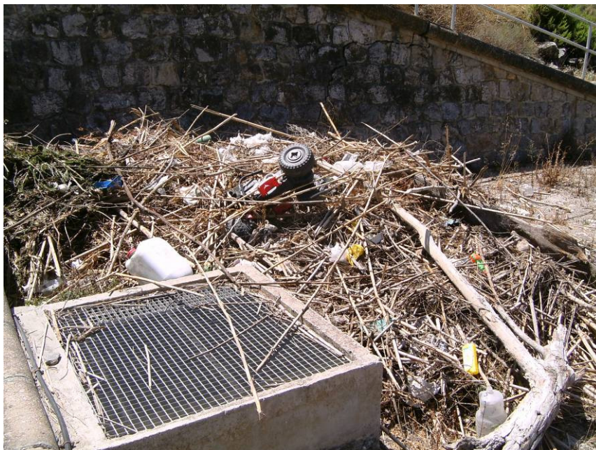
Figura 10. Acúmulo de residuos extraídos del canal de toma del Azud de Vélez (08/08/2011)
