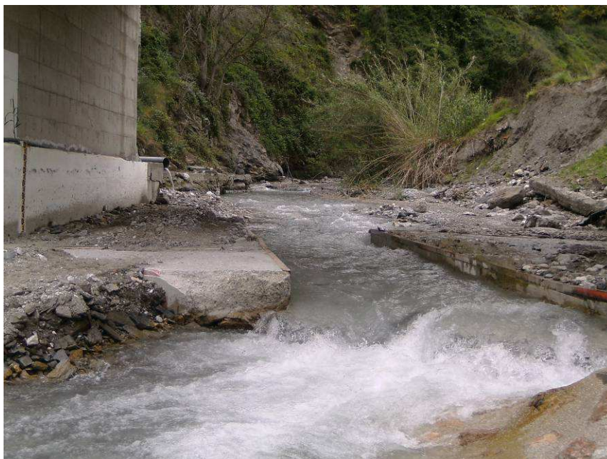
Figura 7. Estación MA-099, al fondo a la izquierda tubo de vertido de aguas residuales. (8/04/2010).
