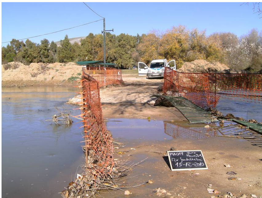
Figura 7. Puente semidestruído sobre el Río Guadalteba (15/12/2010).
