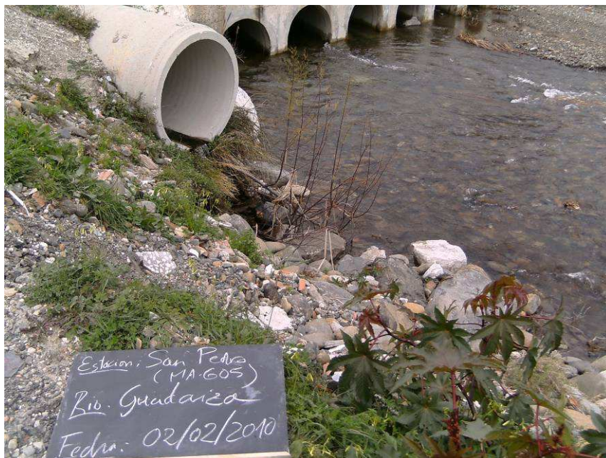
Figura 1. Vertido de agua residual al cauce del río Guadaiza (02/02/2010).
