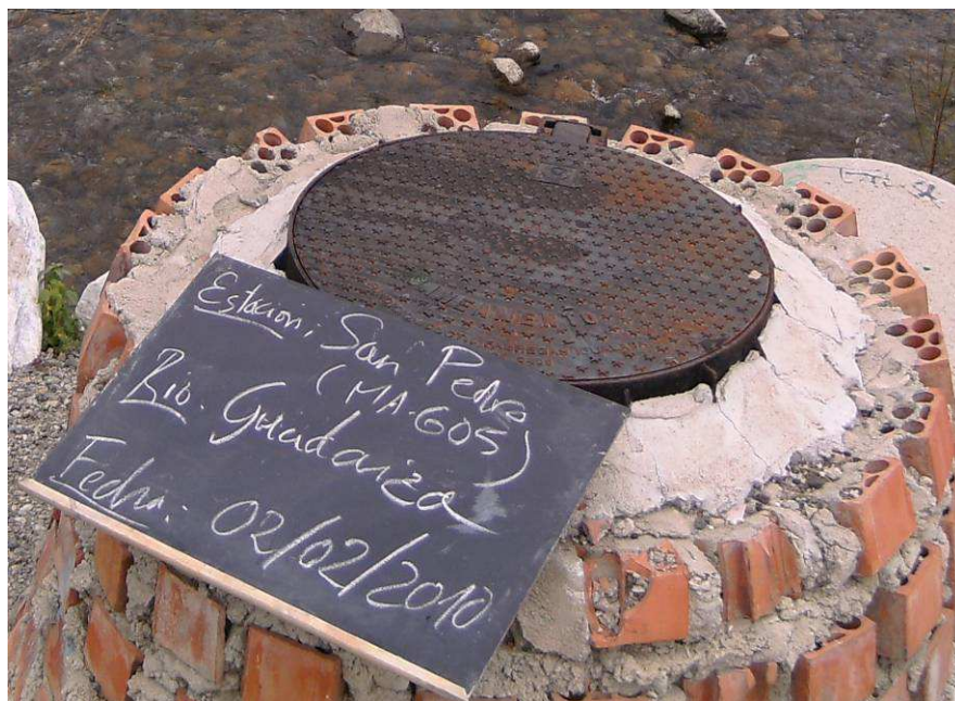
Figura 2. Arqueta de saneamiento desde la que sale el tubo de vertido de agua residual al cauce del río Guadaluza. (02/02/2010).
