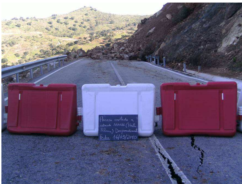
Figura 20. Carretera cortada por desprendimientos (16/03/2010)
