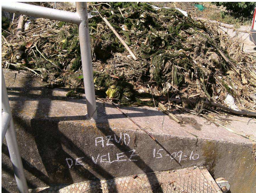
Figura 14. Acúmulo de restos vegetales en el muro de uno de los canales del azud (15/09/2010)
