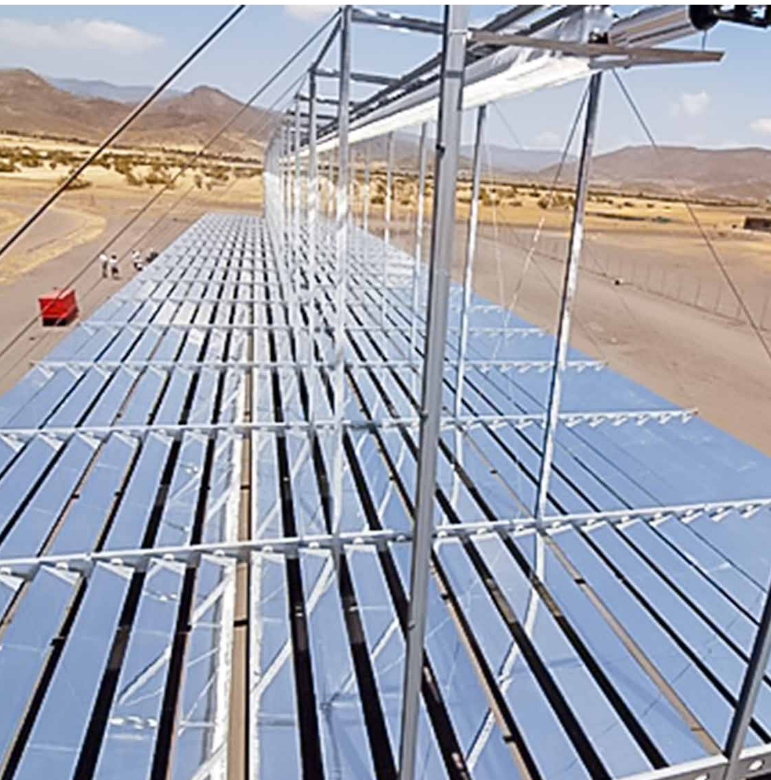
Instalación solar de concentración con tecnología Fresnel.
