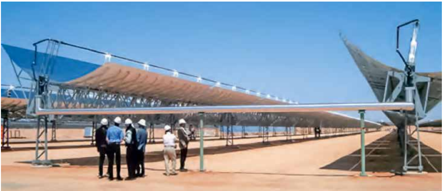
Central termosolar con tecnología de canal parabólico.
