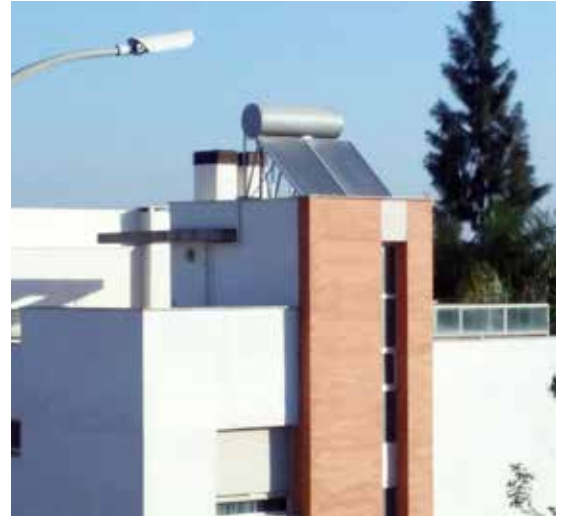
■ Instalación de energía solar térmica. P. Sánchez Lechuga.
