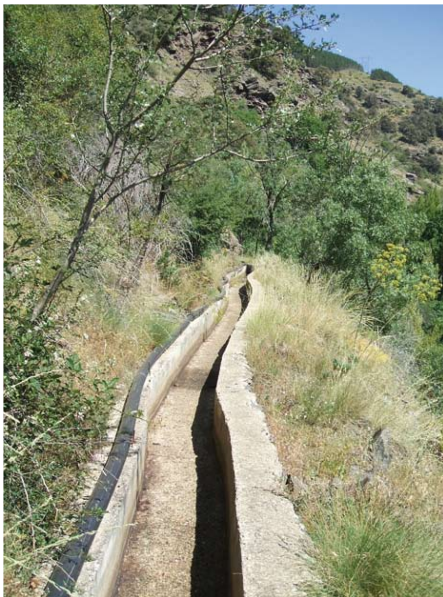
Acequia de Laroles (Granada) hormigonada y con tubería discurriendo en paralelo. (J. C. ÁVILA)
