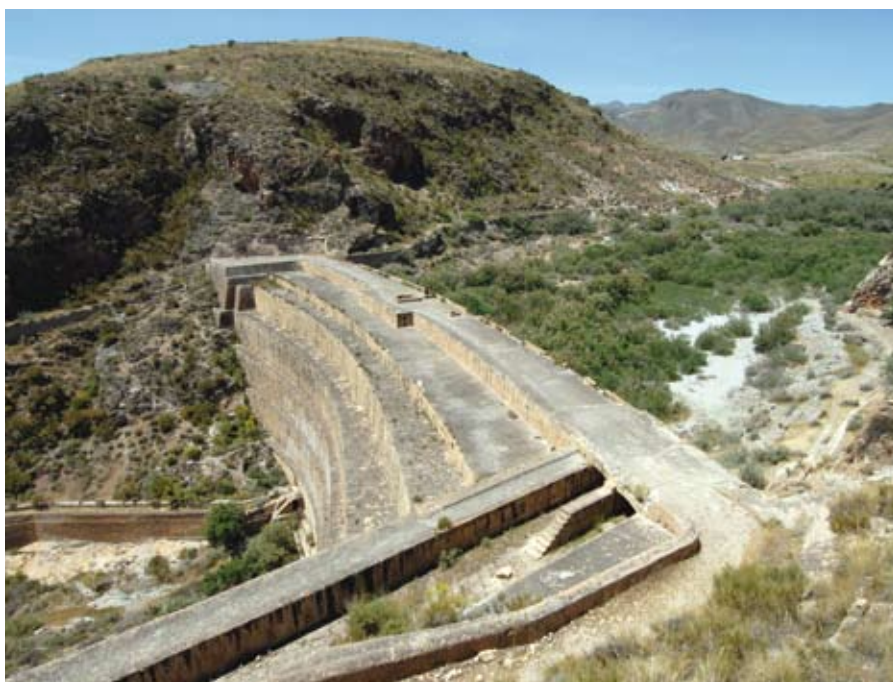
Vista de la presa de Isabel II con el embalse colmatado de sedimentos. (J. M. LÓPEZ MARTOS)
