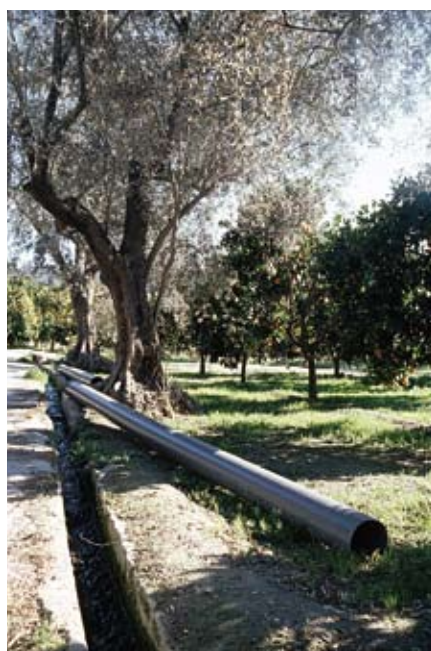
Obras de sustitución de una acequia de hormigón por tubos de riego, en Murchas (Granada). (J. R. GUZMÁN)
