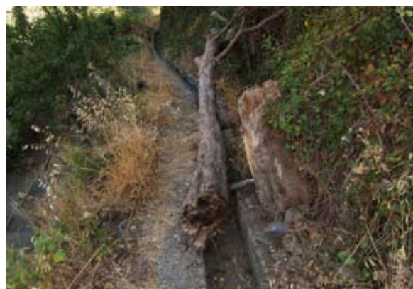
Árbol caído y maleza a lo largo de una acequia sin caudal, Sierrro (Almería). (J. R. GUZMÁN)
