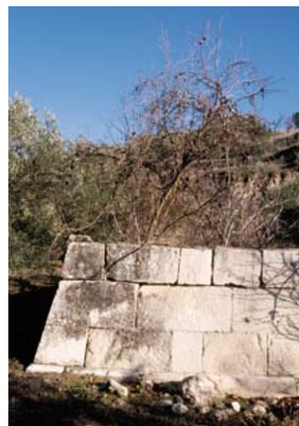
Vestigios de una alberca de construcción romana en El Cañuelo, Priego de Córdoba. (I. R. GUZMÁN)
