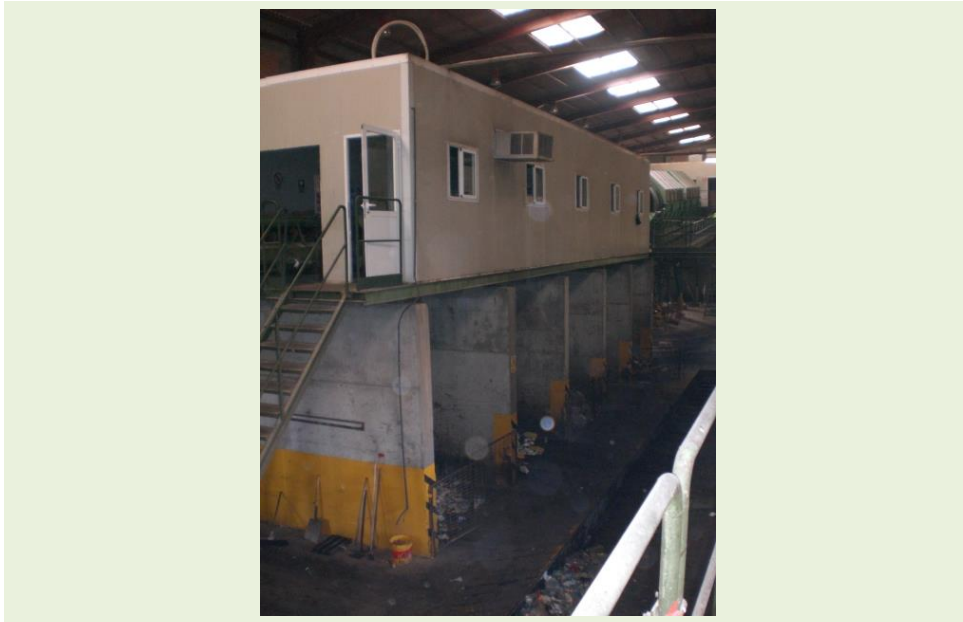
Fotografías nº 85 Cabina de triaje primario
