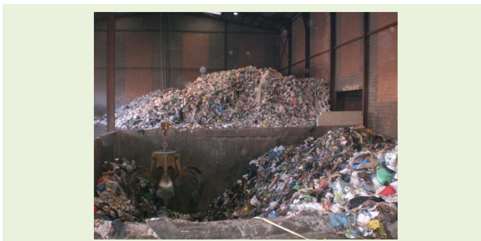
Fotografías nº 84 Foso de recepción de residuos
