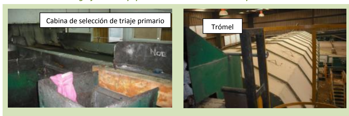
Fotografía nº 2. Equipos asociados a la zona de recuperación.
