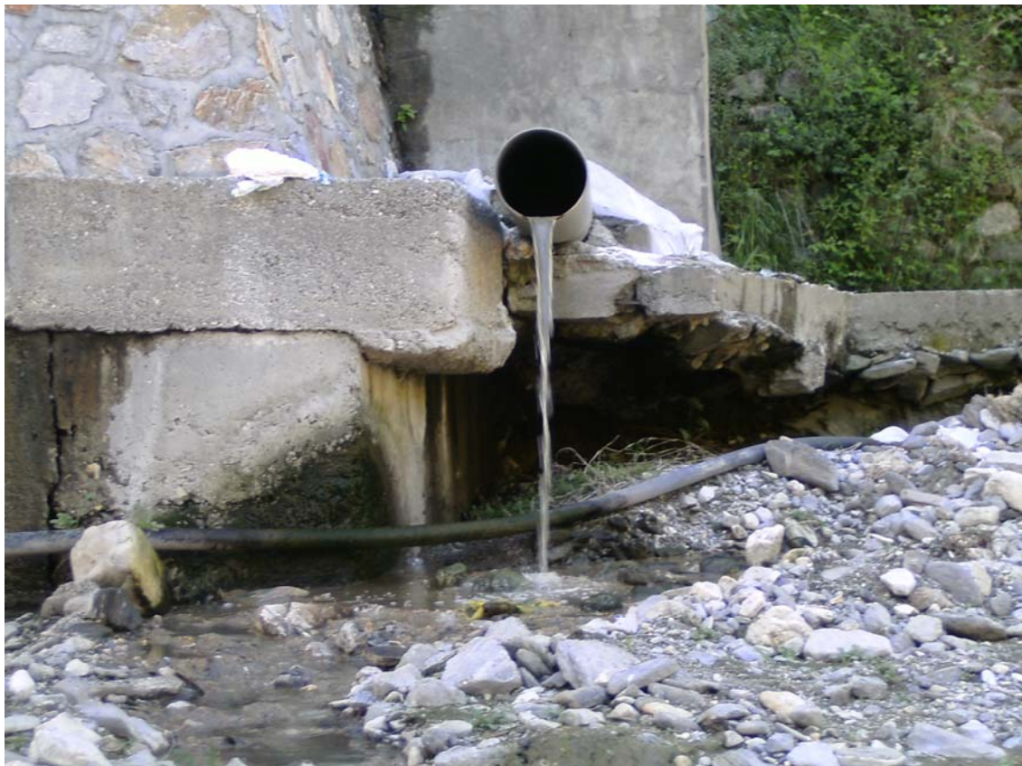
Figura 14. Vertido de aguas residuales al cauce del río de la Toba (21/04/2009).
