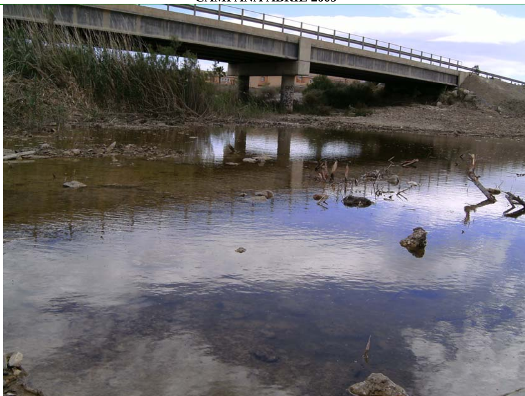
Figura 11. Agua estancada en el río Antas, en la estación de muestreo MA-063 (15/04/2009)
