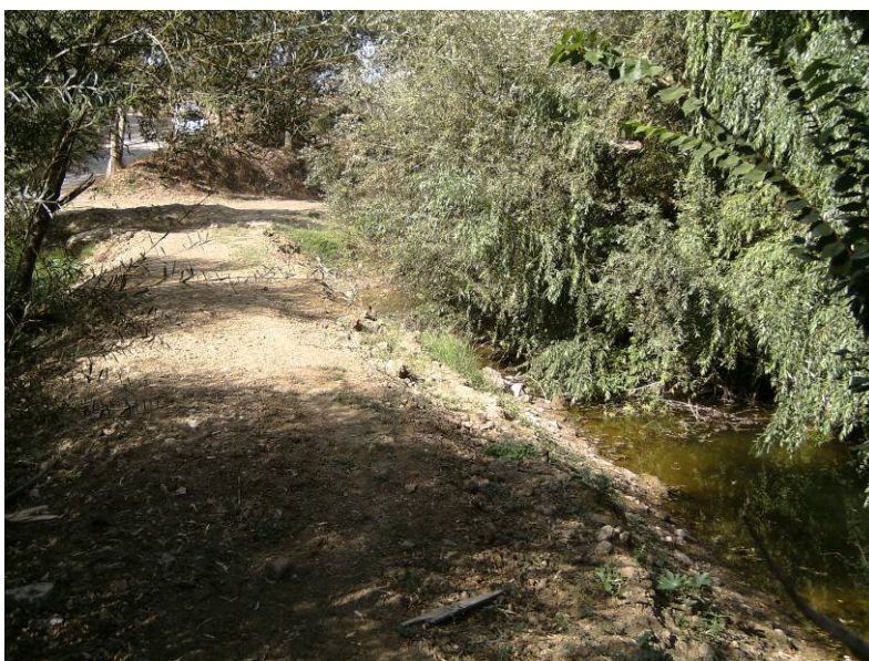
Figura 11. Muro construido en el cauce del río Hozgarganta (12/08/2009).
