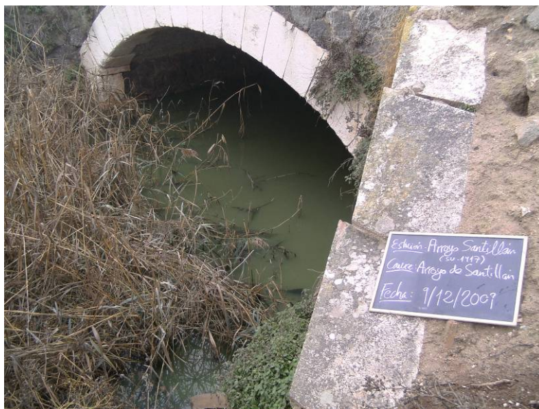
Figura 11. Agua estancada en la estación de muestreo SU-1417 (09/12/2009)
