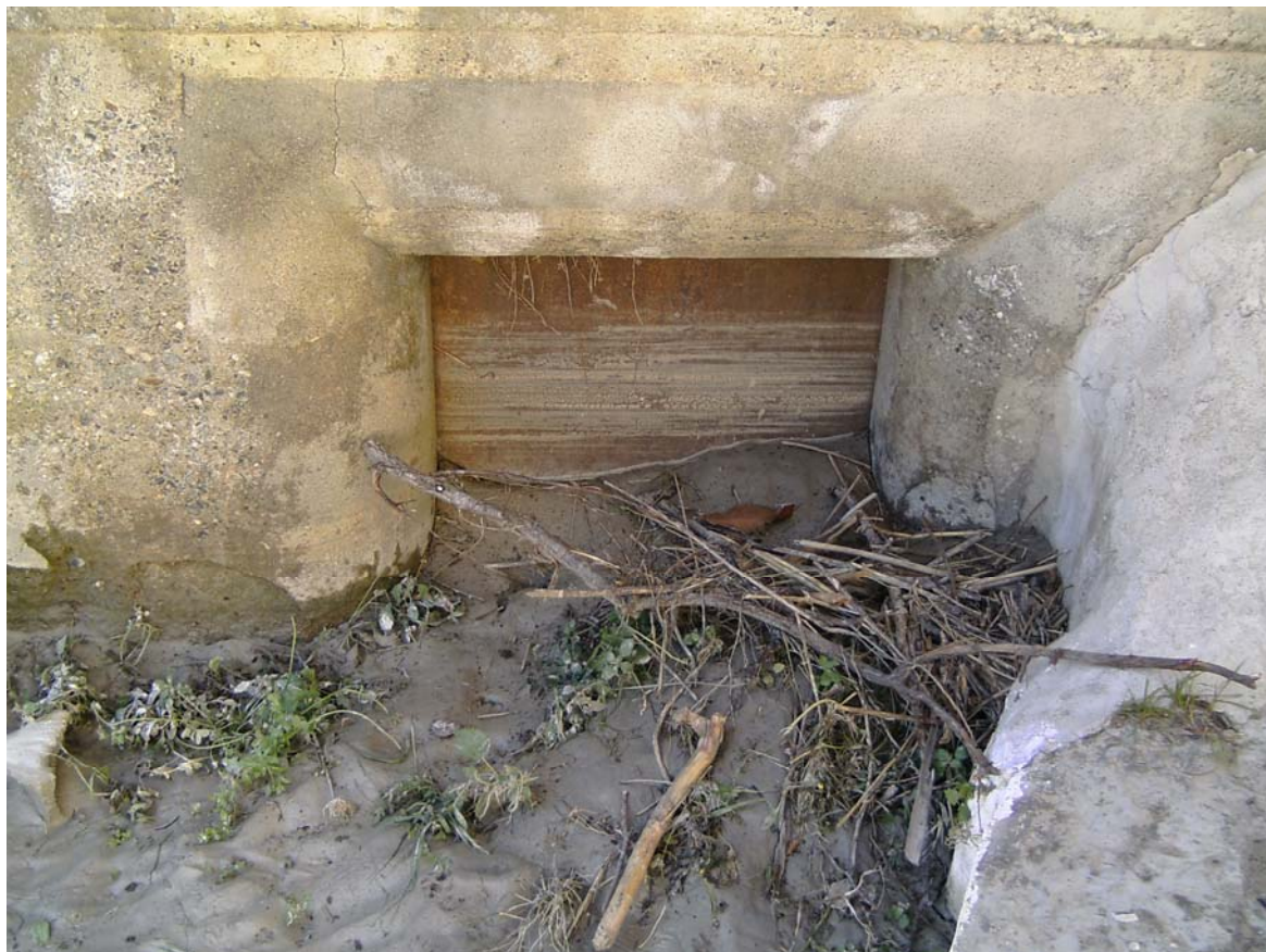
Figura 13. El canal de toma de agua se encontraba cerrado y con acúmulo de restos vegetales y sedimento. La muestra se tomo del cauce del río (11/02/2009).
