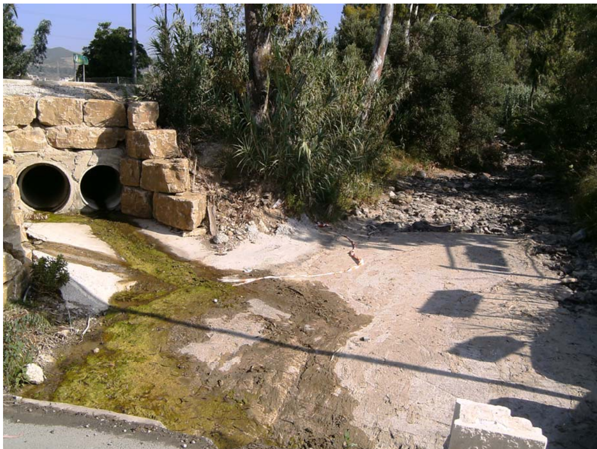
Figura 2. Arroyo Vaquero y tubos de vertido de aguas residuales y/ pluviales de la urbanización Estepona Golf (01/06/2009).
