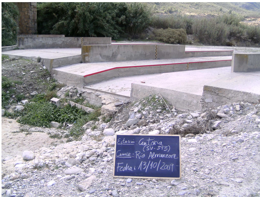
Figura 9. Cauce seco del río Almanzora a su paso por la estación de aforo de Cantoria (13/10/2009).
