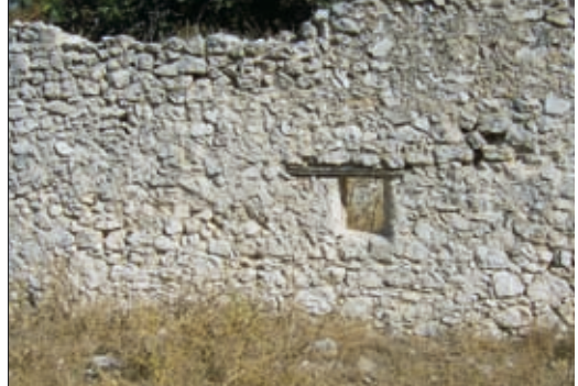
Detalle dintel de madera en ventana
