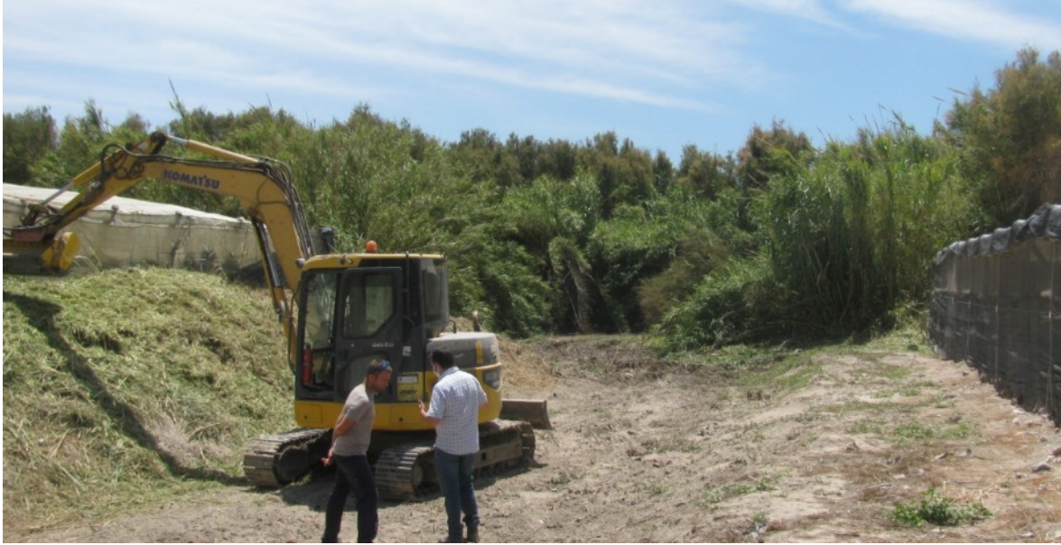
Foto 24. Detalle de una de las actuaciones realizadas en el marco del servicio de limpieza y acondicionamiento de cauces de la provincia de Almería 2019-2021 en el espacio ES6110001 Albufera de Adra.
