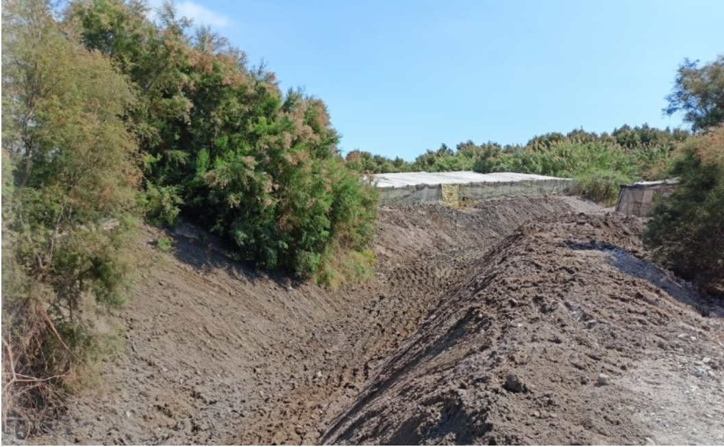
Foto 26. Resultado de de una de las actuaciones realizadas en el marco del servicio de actuaciones de conservación, mantenimiento y restauración del dominio público en la provincia de Almería 2021-2023 en la rambla de la Estanquera, en el espacio ES6110001 Albufera de Adra.
