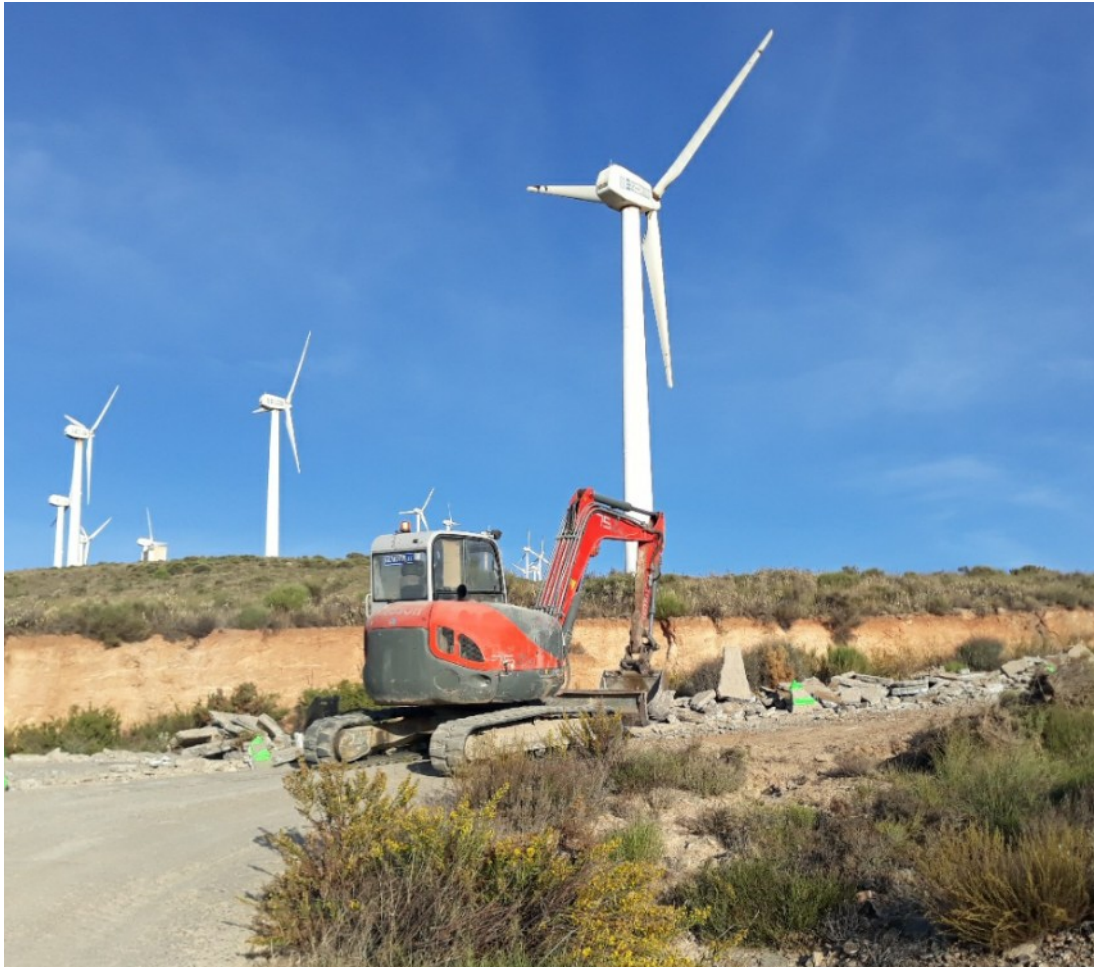
Foto 23. Detalle de una de las actuaciones llevadas a cabo en el marco del proyecto de implementación de la red prioritaria de infraestructuras verdes en el medio rural, fase II (2019-2022) en el término municipal de Enix, dentro del espacio ES6110008 Sierras de Gádor y Enix.
