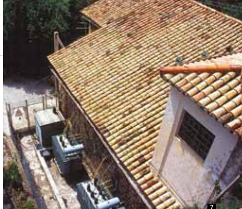
Central hidroeléctrica el Nacimiento
