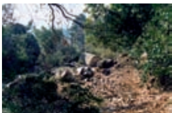
Captación del manantial del Hornillo.
