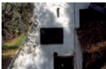
Infraestructura para captación en el Salto de Padilla.
