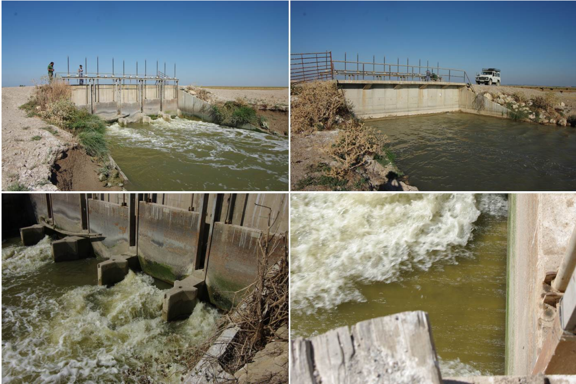
Figura 53. Compuertas sobre el caño del Cherry.
