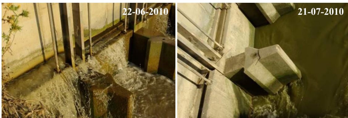
Figura 68. Estado de apertura de las compuertas durante los meses de junio y julio de 2010.
