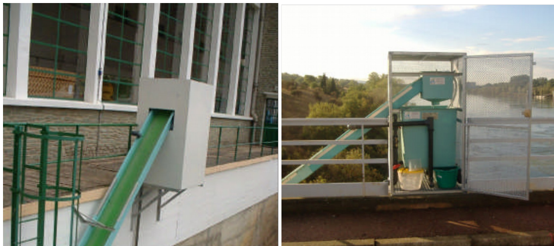
Figura 15. Apariencia externa de un paso trampa constituido por la rampa y la cabina protectora (izquierda). Interior de la cabina donde se observa el depósito receptor (con aireador) y las tuberías que aportan tanto el caudal de la rampa como el de atracción (derecha) (Fotos: www.fish-pass.fr ).
