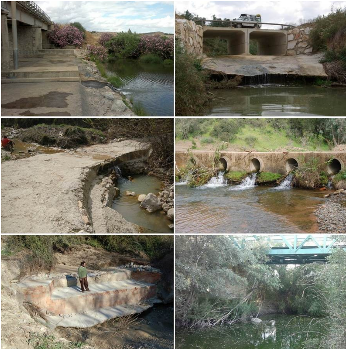
Figura 18. Ejemplos de barreras en la cuenca del Guadalquivir por debajo de la presa de Alcalá del Río. De arriba abajo y de izquierda a derecha: puente de carretera principal y secundaria, vado de camino y de vía pecuaria, dique y puente para el ferrocarril.
