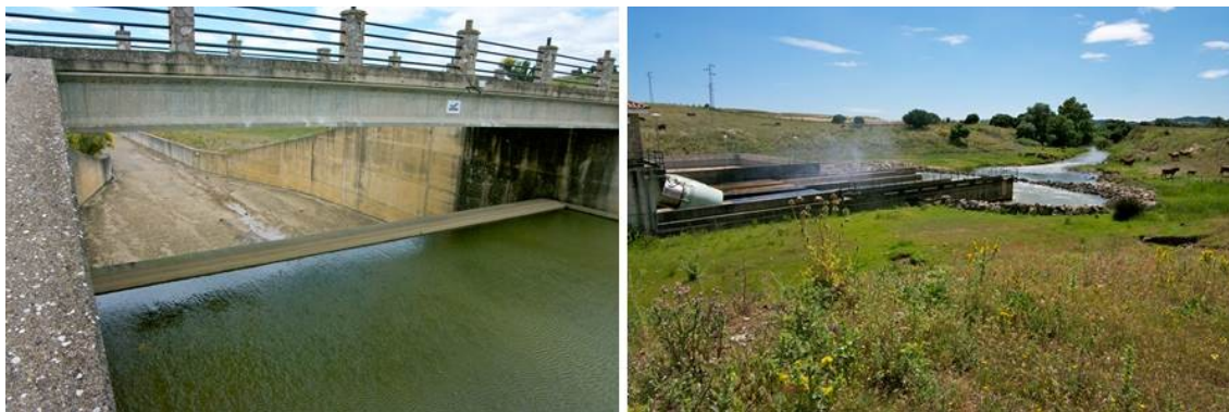
Figura 9. Aliviadero (izquierda) y conducto de base (derecha) de la presa de Barbate.
