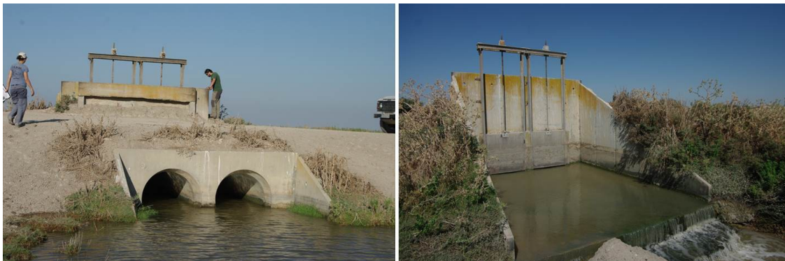
Figura 52. Compuertas sobre el caño de la Carrajola.
