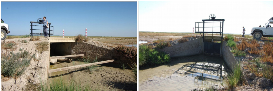
Figura 61. Compuertas sobre los caños de los Rompidos.
