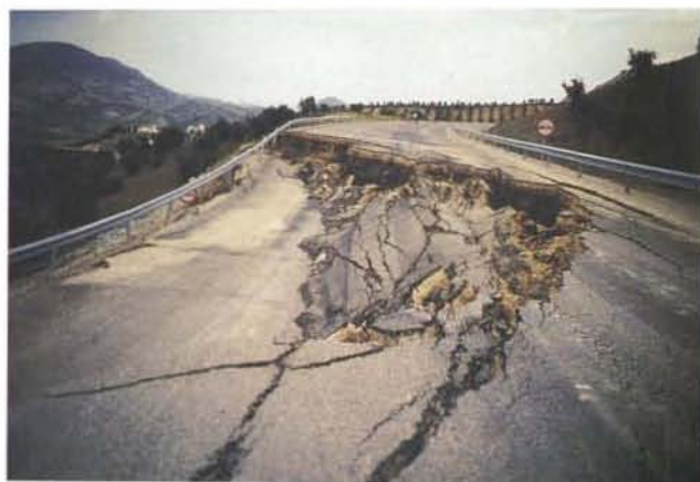
Rotura de la carretera Granada-Jaén en el puerto Carretero como consecuencia de un deslizamiento. Foto: Guillermina Garzón.
