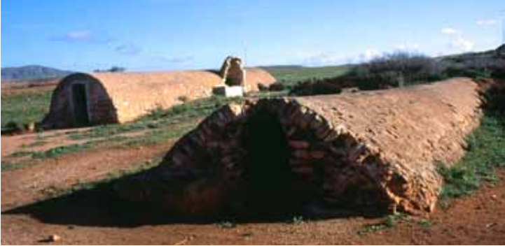
Desde antiguo los pobladores de Cabo de Gata han desarrollado una tecnología eficaz para aprovechar los escasos recursos hídricos. En la foto aljibes de Los Nietos.
