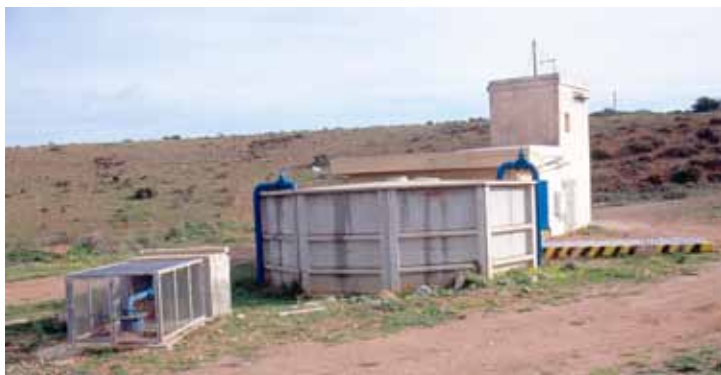
Sondeo de captación para abastecimiento urbano a San José, en el entorno del Nazareno.
