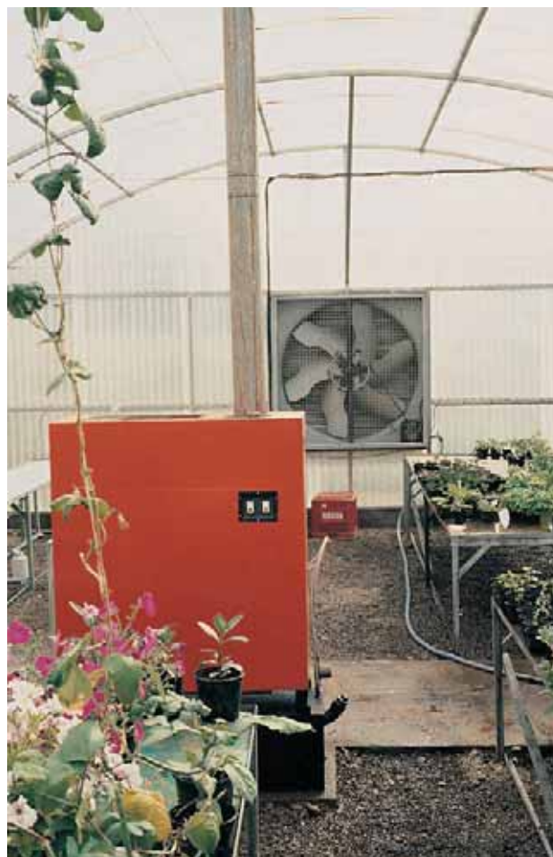
Foto 8. Generador de agua caliente
