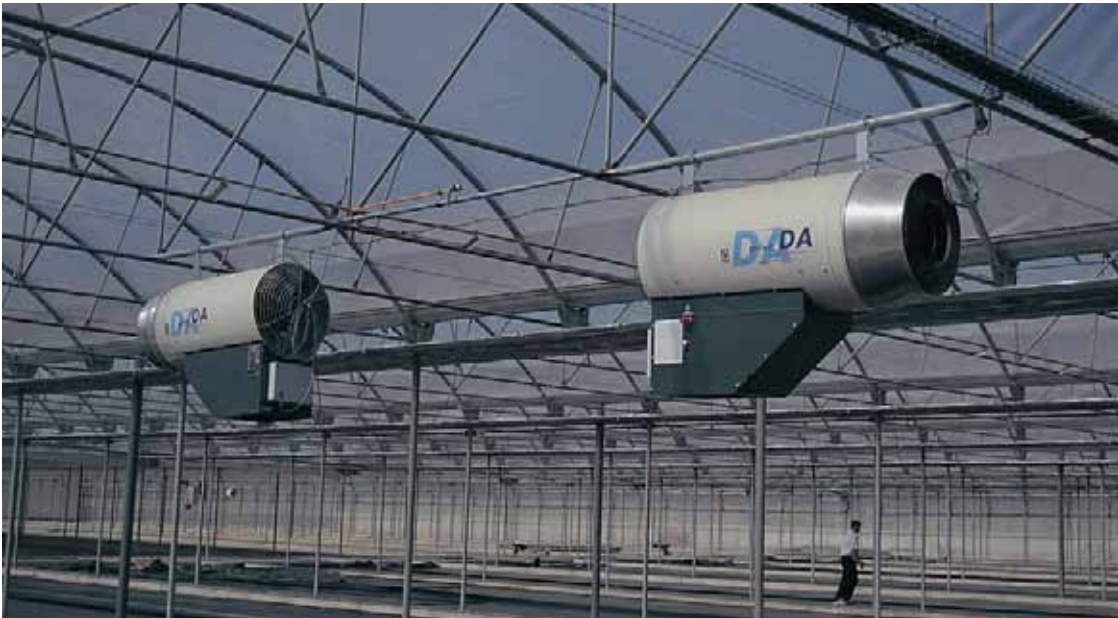
Foto 9. Generador de aire caliente
