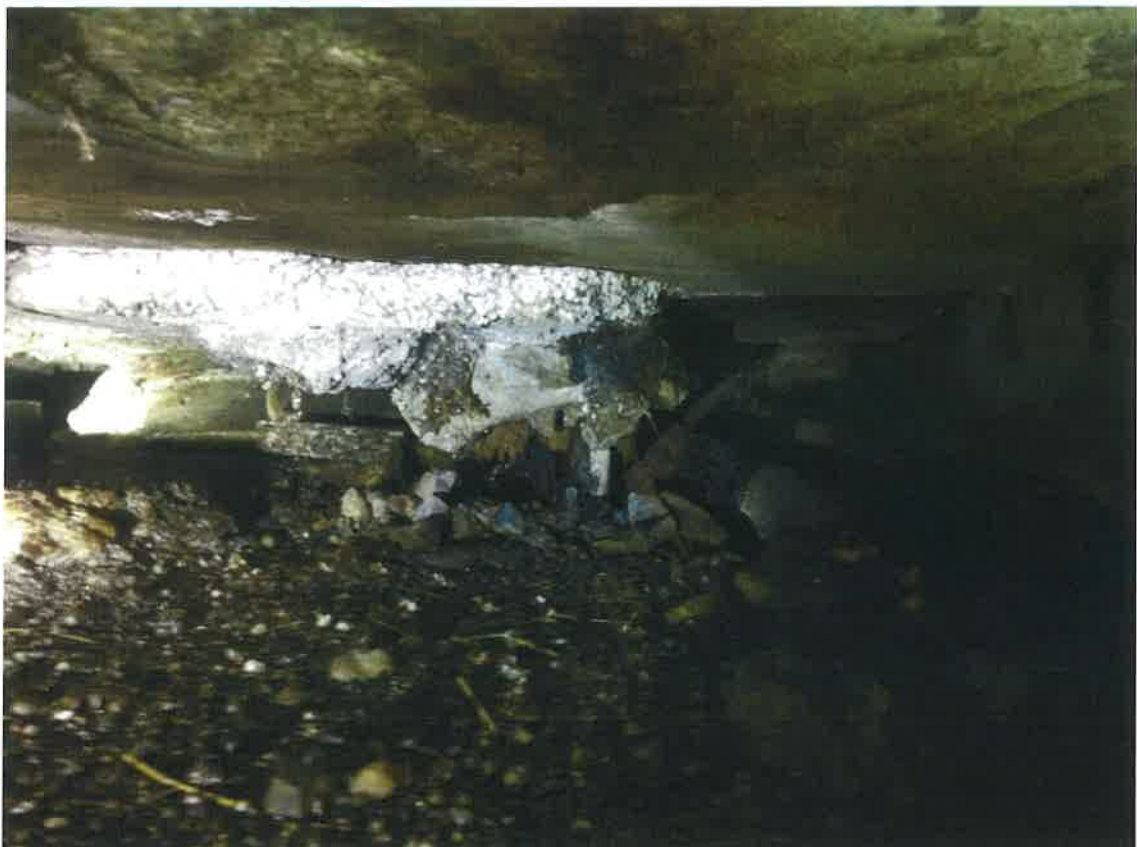
Cordones del anclaje rotos
