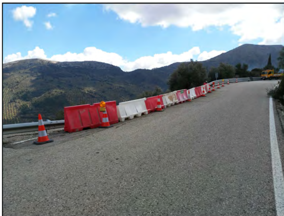
A-6050 P.K. 17+000. Señalización y balizamiento de la incidencia.
