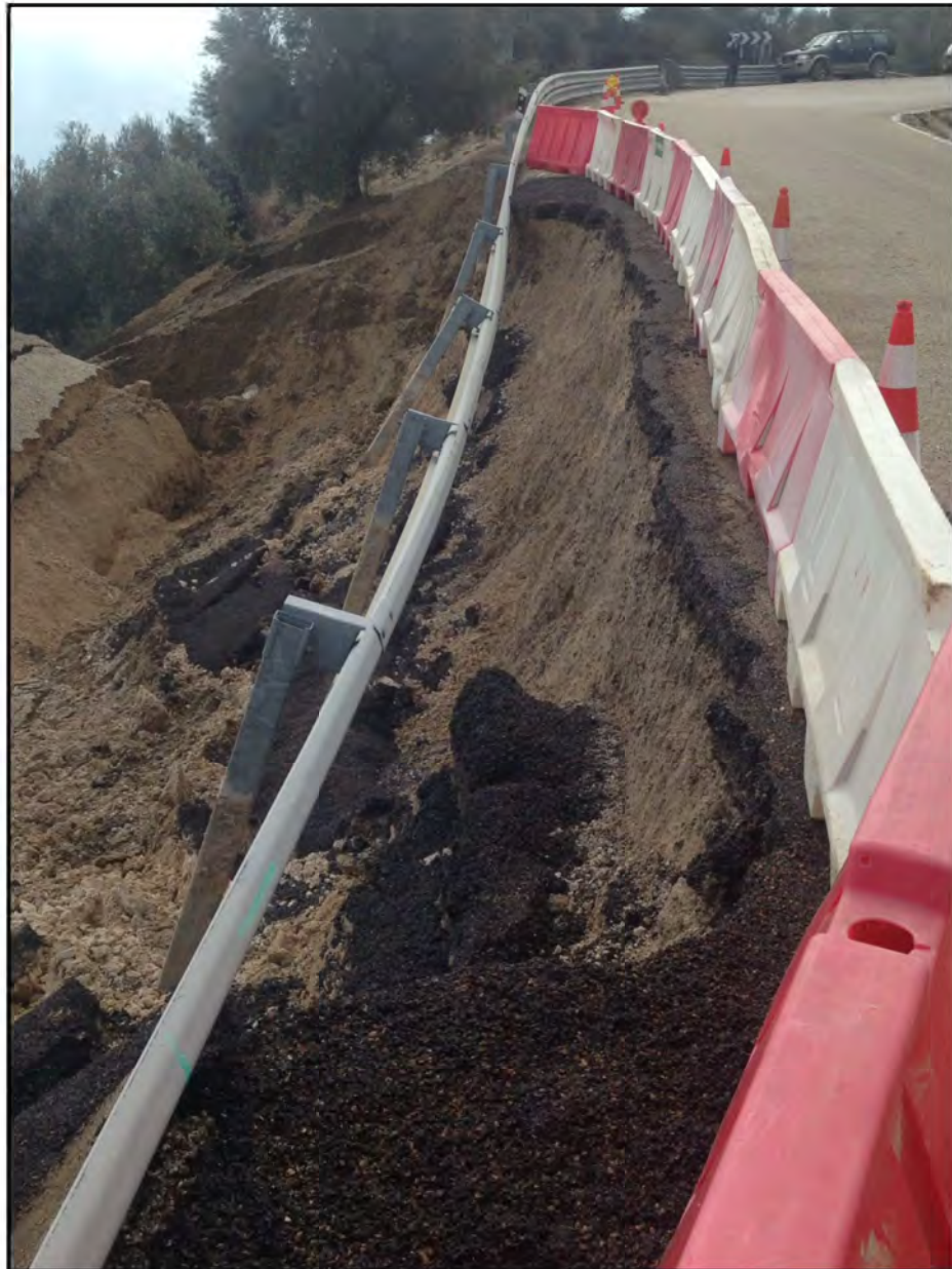
A-6050 P.K. 17+000. Zona afectada por deslizamiento parcial de la calzada tras colapso de muro de gaviones existente en talud de terraplén.
