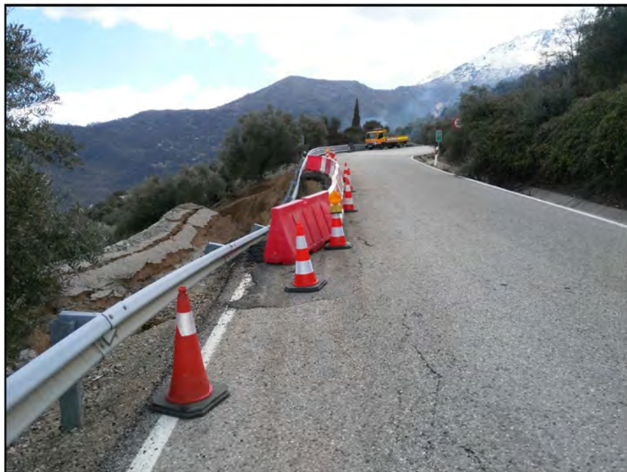
A-6050 P.K. 17+000. Señalización y balizamiento de la incidencia.
