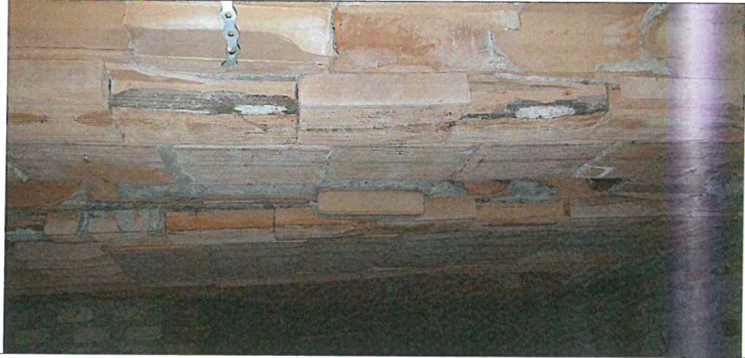
Foto 2 Detalle del estado del forjado.
