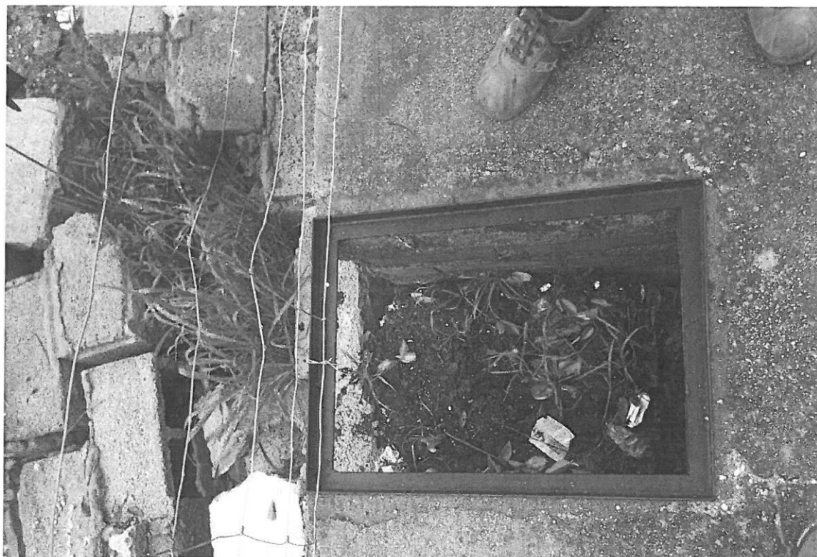
ARQUETA SUMIDERO EXISTENTE, TOTALMENTE LLENA DE ARIDOS Y HOJAS
