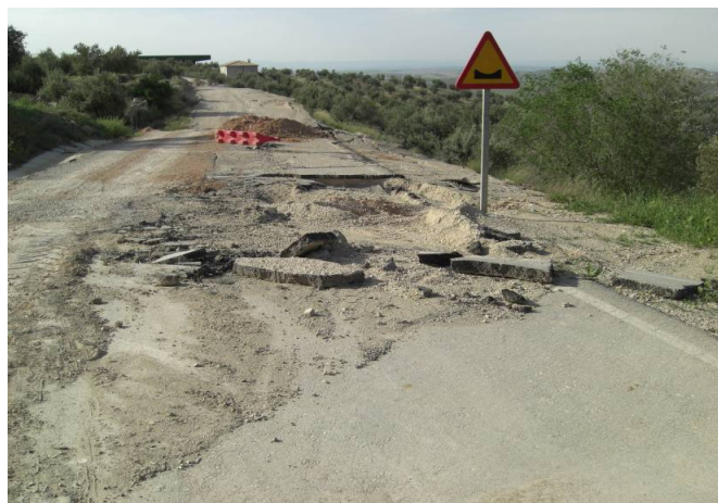
Desperfectos sobre JA-3200 producidos por desprendimientos
