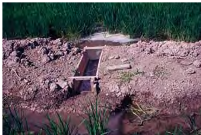
Fig. 7.85.- Piquera entre dos tablas. Al lado, los cangrejos han horadado el almorrón provocando el desagüe incontrolado de agua
