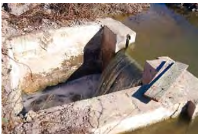
Fig. 5.2.- Piquera de salida (con "caja" regulable) y pileta de desagüe
