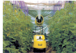
Figura 6. Nebulizador en frío, instalado en el interior de un invernadero
