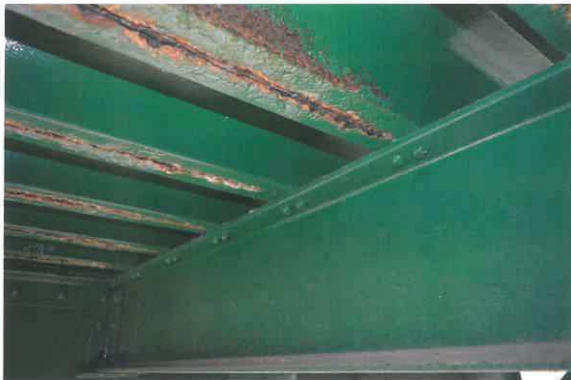
Detalle del deterioro de algunos perfiles omega en las inmediaciones de un larguero interior
