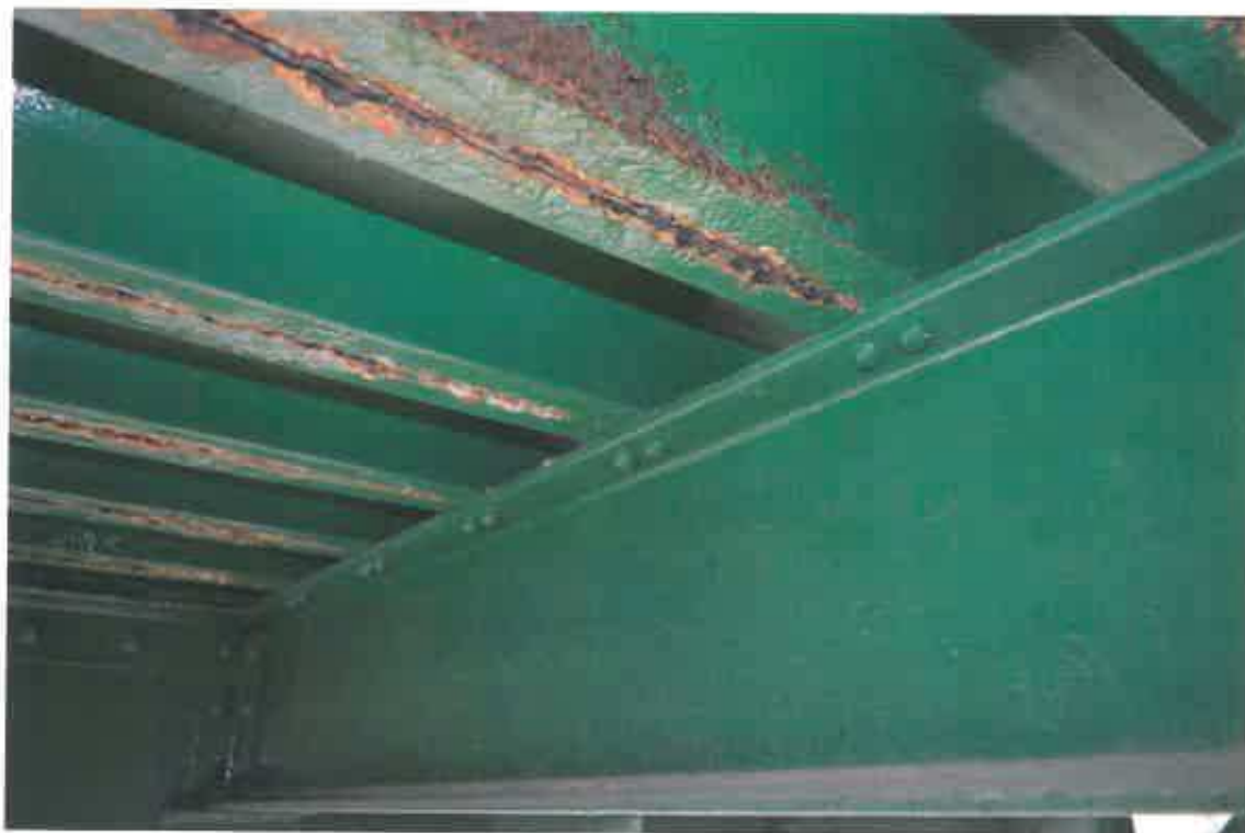
Figura 7. Detalle del deterioro de algunos perfiles omega en las inmediaciones de un larguero interior
