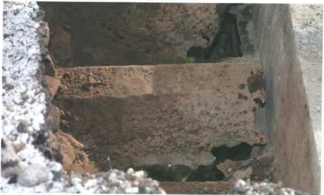
Figura 4. Aspecto del apoyo ya inexistente de los perfiles omega en el larguero longitudinal extremo izquierdo (en el caso de la fotografía, en el que también ha desaparecido el ala del angular de apoyo).
