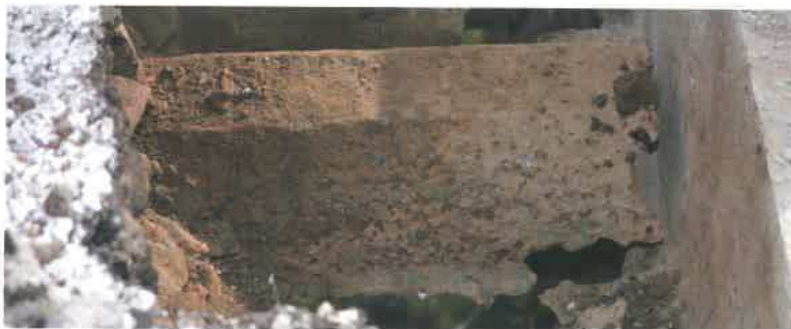
Aspecto del apoyo, ya inexistente, de los perfiles omega en el larguero longitudinal extremo izquierdo (en el caso de la fotografía), en el que también ha desaparecido el ala del angular de apoyo
