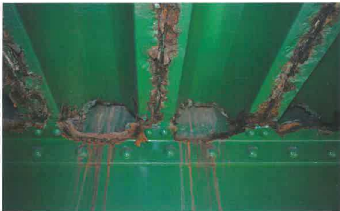
Detalle del deterioro del ala superior del angular de apoyo
