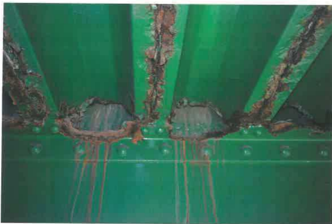
Figura 6. Detalle del deterioro del ala superior del ángulo de apoyo
