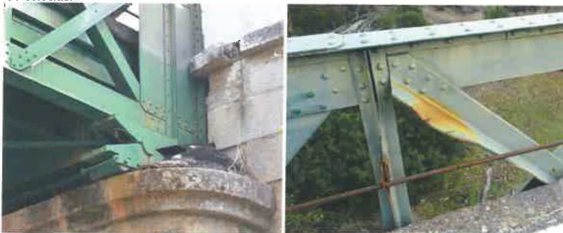
Aparato de apoyo desplazado en estribo 1 y daños por impacto en perfiles metálicos
