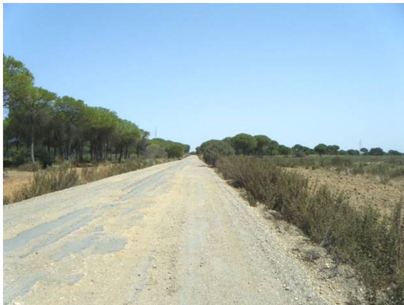
Imagen 2. Estado del viario en itinerarios rurales principales
