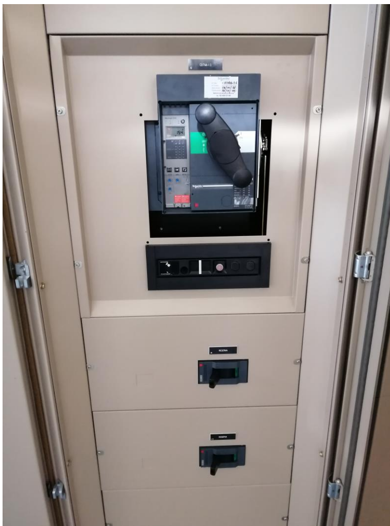
Interruptores de reserva de 250/630A en CBT1
