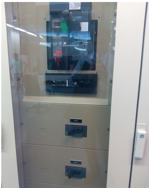
Interruptores de reserva de 250/630A en CBTA-A
