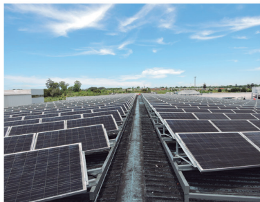
Cubierta privada. Uruguay 514,5kW
