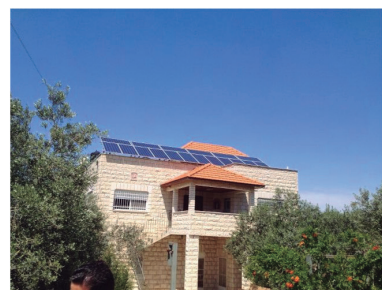
Cubierta privada. Palestina 5kW
