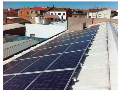
Cubierta privada. España 14,3kW
