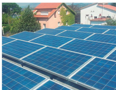
Cubierta privada. España 9,31kW
