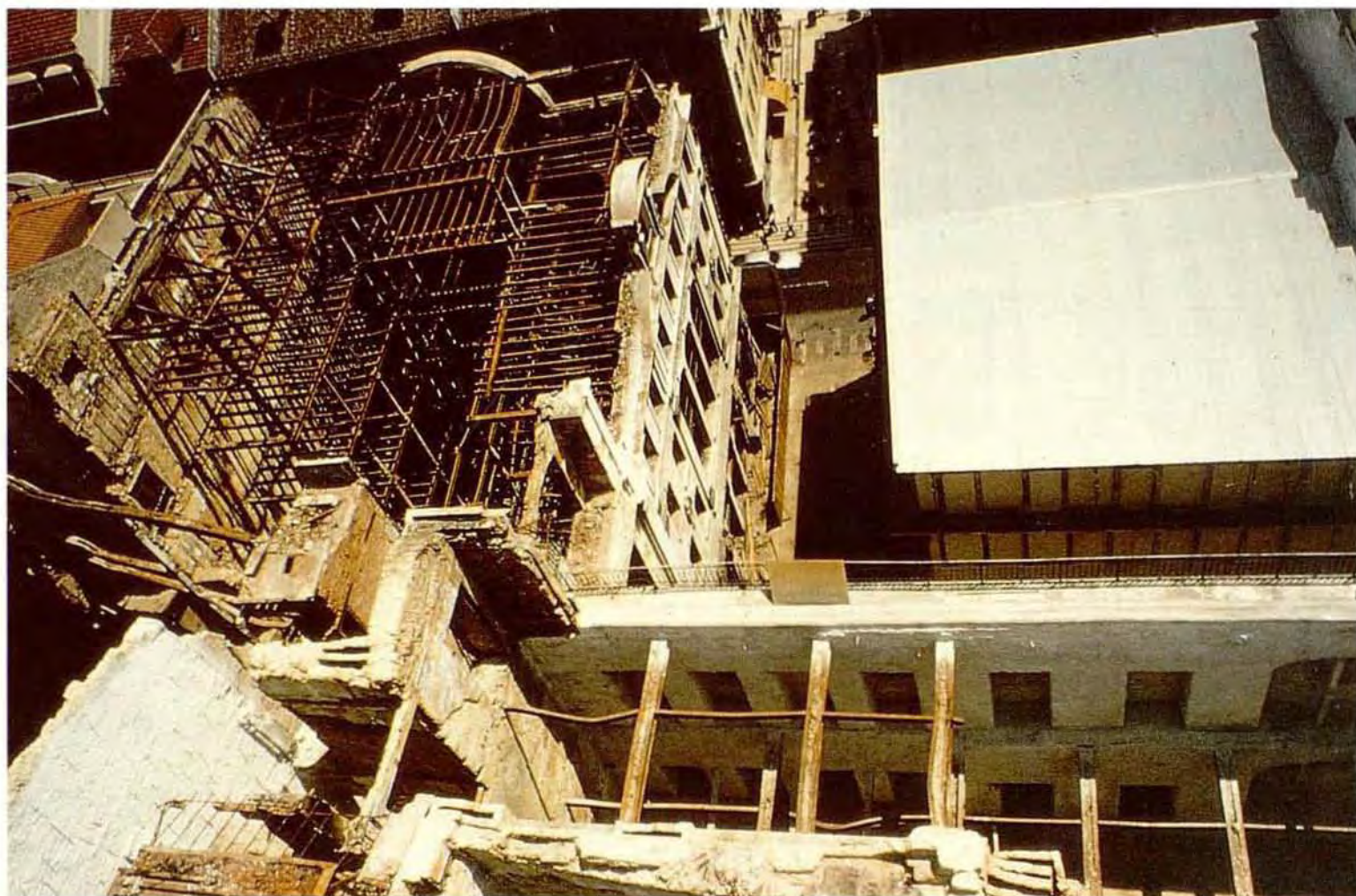
Vista cenital del edificio Grandella tras el incendio. La estructura aparece calcinada por el fuego.
