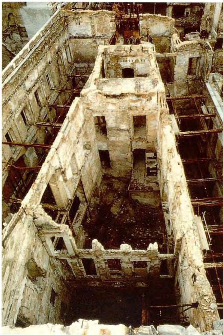
Vista cenital de los Grandes Almacenes del Chiado mostrando su estructura después del incendio.
