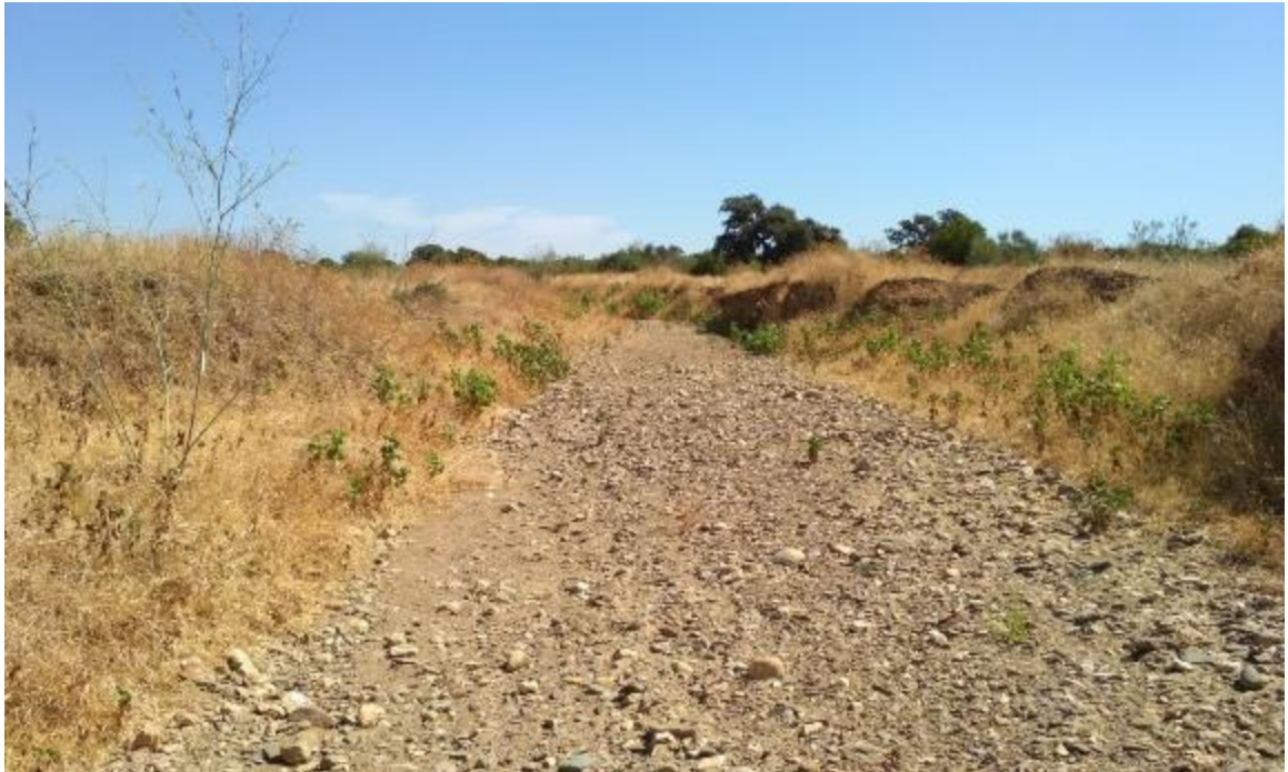
Figura 5.6 Terrenos atravesados por la conducción en modo subterráneo tras el segundo cruce del río Crispinejo, en los que se aprecia la presencia de cantos y gravas aluviales
