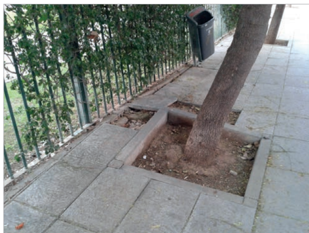
Imagen 1.5_2. Árbol viario inclinado por un deficiente volumen de alcorque.
