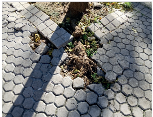
Imagen 1.5_46. Pavimento levantado por raíces al no poder penetrar en un suelo compactado o duro.
