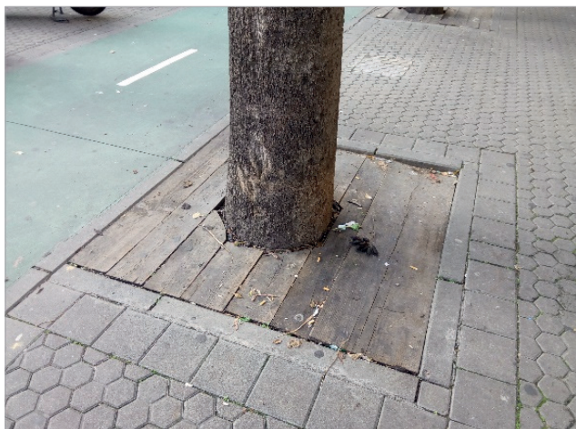
Imagen 1.5_35. Alcorque cubierto con planchas de madera.
