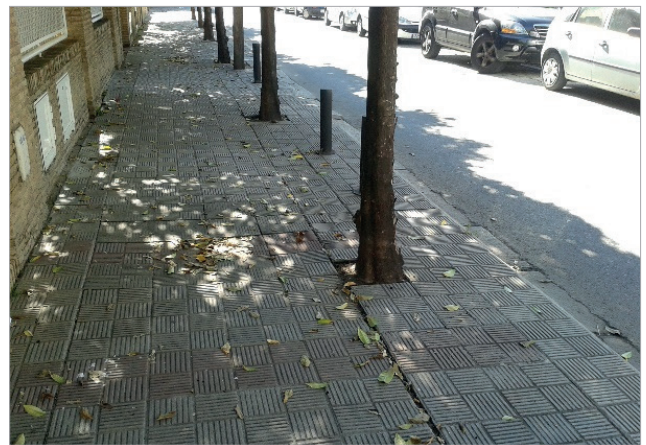
Imagen 1.5_32. Alcorque cubierto con losetas de pavimentación. La necesidad de agua y de oxígeno del sustrato, se ven limitadas por no tener una superficie libre de intercambio.
