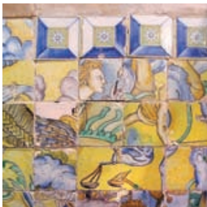
Detalle del frontal de altar en el que se aprecian algunos de los deterioros descritos. Las pérdidas de piezas originales y la ubicación errónea de las conservadas, imposibilitan la lectura correcta de la escena.
