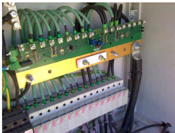
Imagen 12 Detalle sistema monitorización
