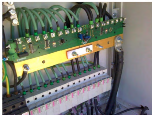
Imagen 12 Detalle sistema monitorización
