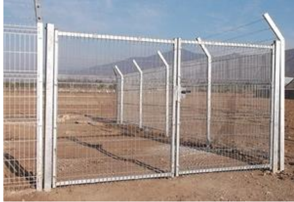
Figura 4.2.7.b Detalle de portón de dos hojas batientes tipo Acmafor. Fuente: Proyectos de Ejecución Planta Fotovoltaica Venta Angulo, Los Llanos y Las Canteras. T.M. Caniles (Granada).
