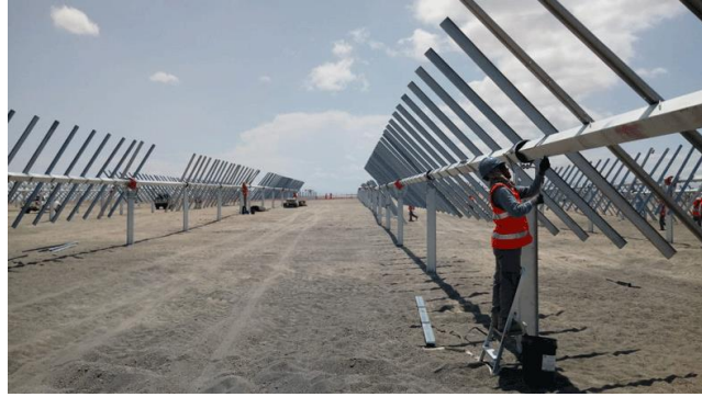
Figura 4.2.11.a. Montaje de estructura seguidor con perfiles hincados directamente en el terreno. Fuente: Proyectos de Ejecución Planta Fotovoltaica Venta Angulo, Los Llanos y Las Canteras. T.M. Caniles (Granada).
