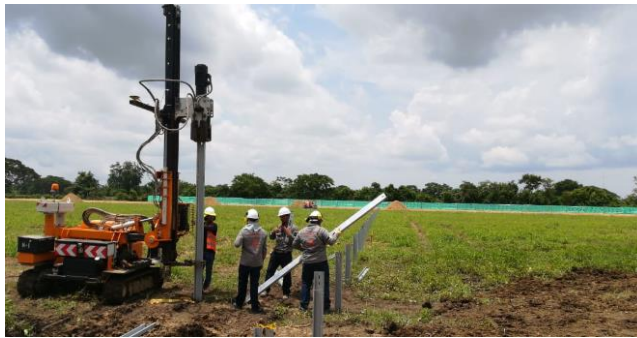
Figura 4.2.9.a. Hincado de perfiles con maquinaria especializada. Fuente: Proyectos de Ejecución Planta Fotovoltaica Venta Angulo, Los Llanos y Las Canteras. T.M. Caniles (Granada).
