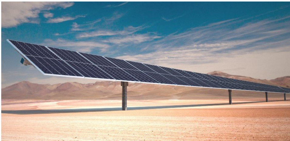
Figura 4.1.5.a. Seguidor Solar. Fuente: Proyectos de Ejecución Planta Fotovoltaica Venta Angulo, Los Llanos y Las Canteras. T.M. Caniles (Granada).
