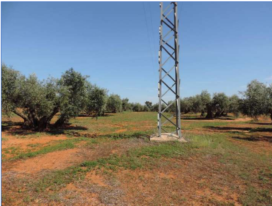
Figura 13. Apoyo de línea. Fuente propia.
