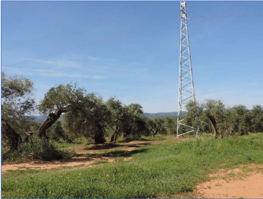
Figura 12. Apoyo de línea. Fuente propia.
