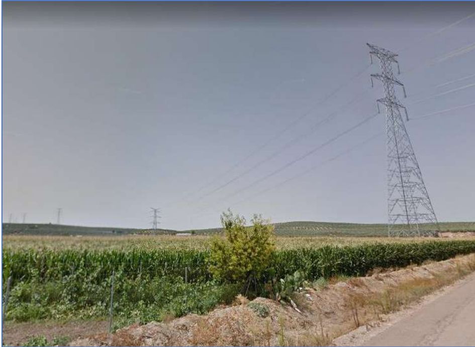
Figura 13. Apoyo de línea. Fuente propia.
