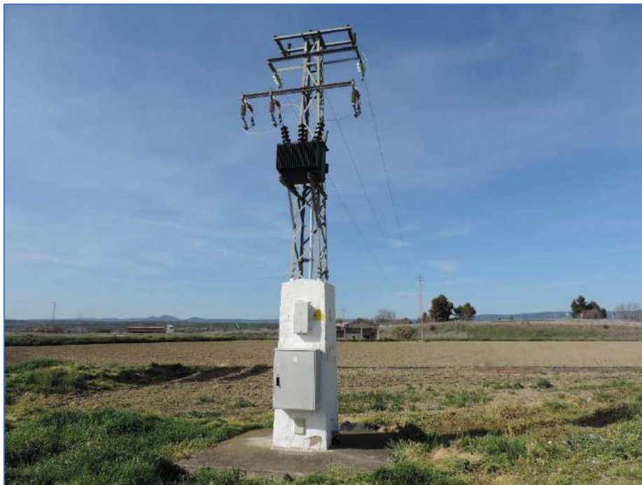
Figura 14. Apoyo de línea. Fuente propia.
