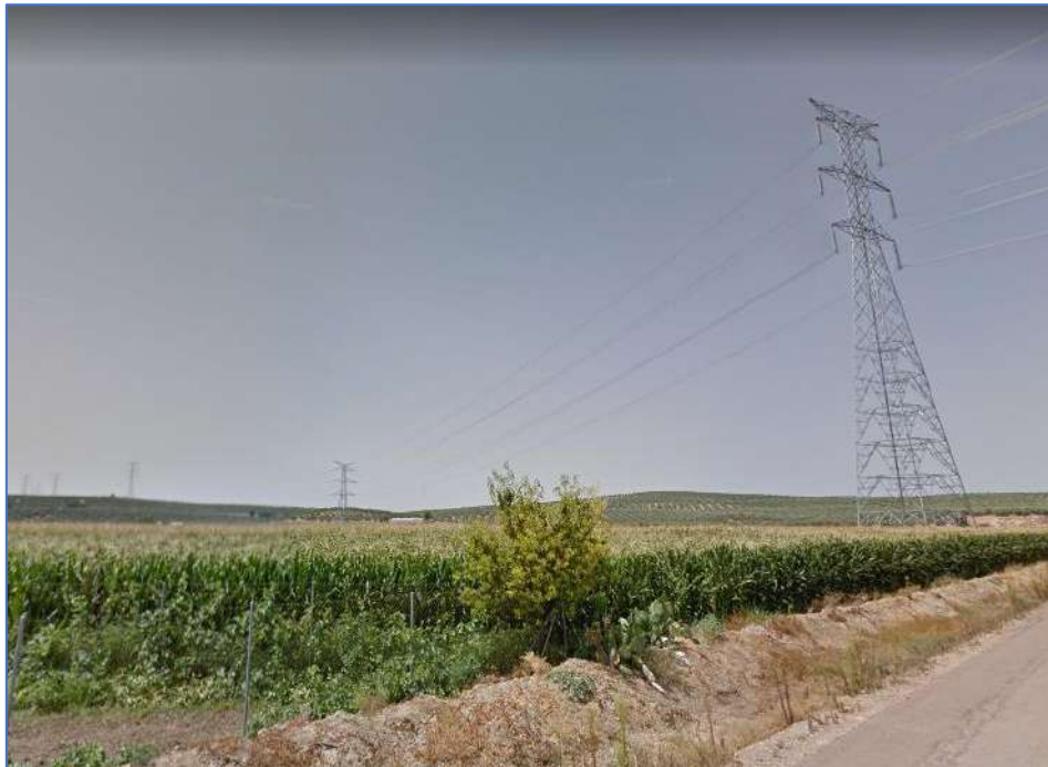
Figura 12. Apoyo de línea. Fuente propia.
