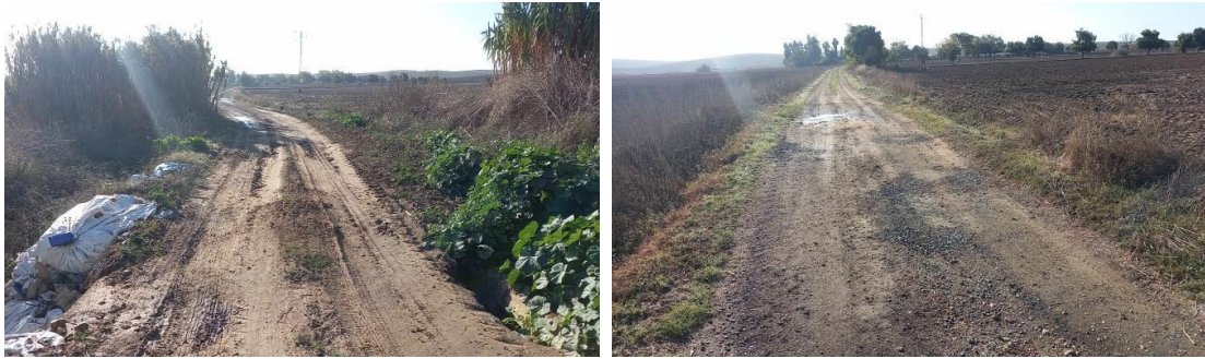
Puntos con firme deteriorado en tramo de plataforma con pavimento granular
