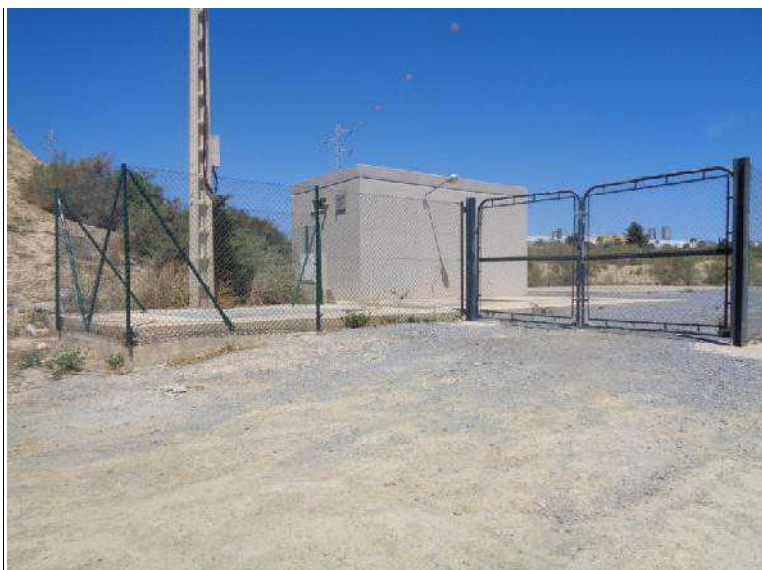
Foto 27: Sector DP 02, transformador situado en la zona sur
