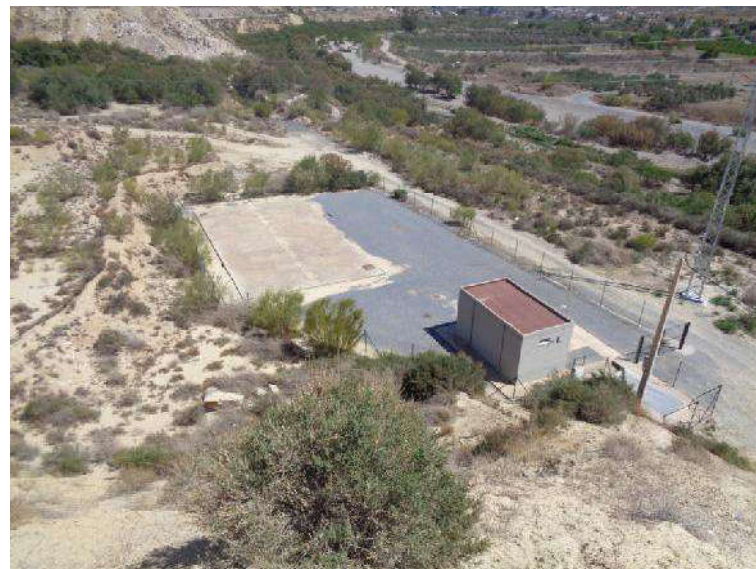
Foto 46: Sector DP 02, emplazamiento de un transformador en la zona sur.
